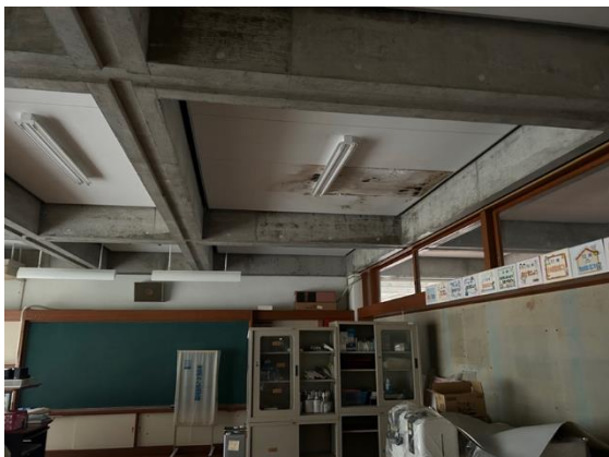
16 雨漏り箇所（1F 保健室）
