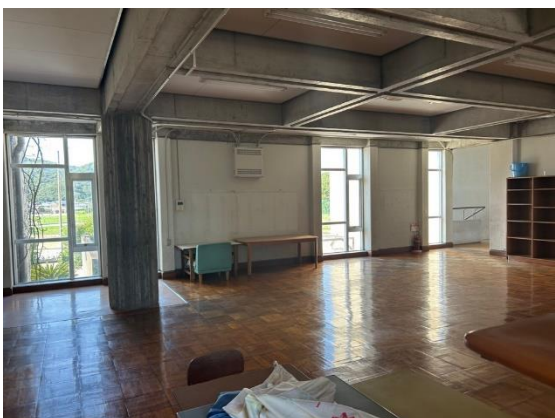
17 雨漏り箇所（2F フロア）
