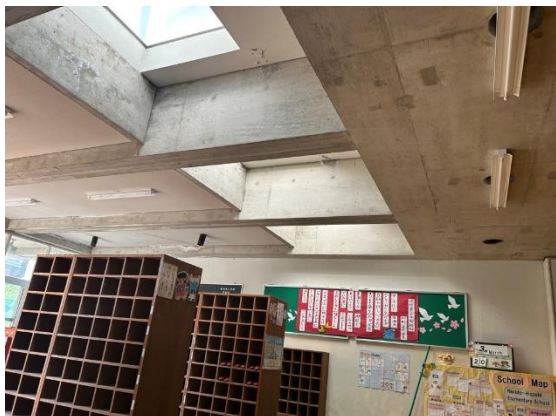
13 雨漏り箇所（1階玄関ホール）
