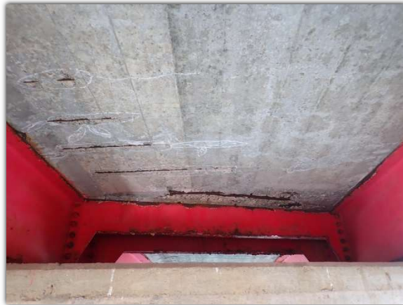
写真 4. コンクリート床版の剥離・鉄筋露出
