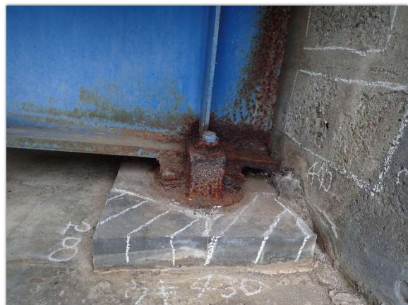
写真 5. 支承の機能障害
