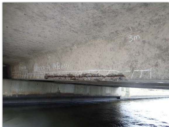
写真 3. コンクリート桁の剥離・鉄筋露出
