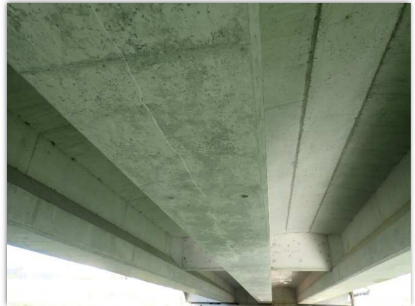
写真 2. コンクリート桁のひび割れ・遊離石灰
