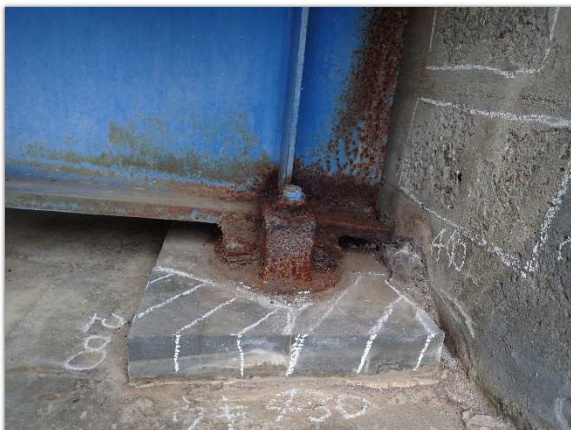
写真 5. 支承の機能障害
