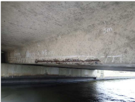
写真 3. コンクリート桁の剥離・鉄筋露出
