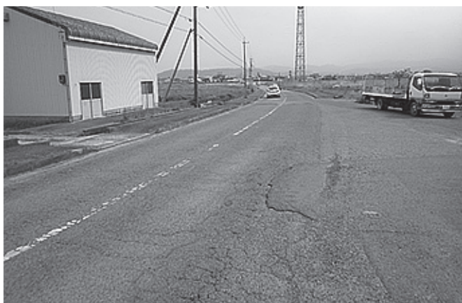
舗装修繕が必要な生活道路
