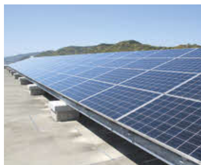
▲屋上階の太陽光発電装置
