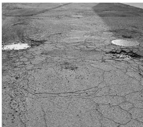
早期修繕が望まれる生活道路
