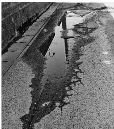
修繕が追いつかない市道
