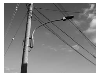
LED化された道路照明灯
