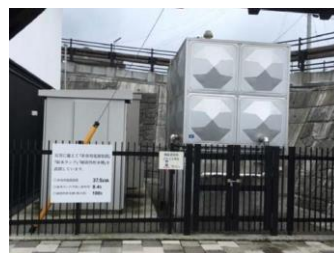
耐震性貯水槽と非常用電源装置 （道の駅 天空の郷さんさん）
