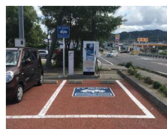
電気自動車（EV）充電施設
