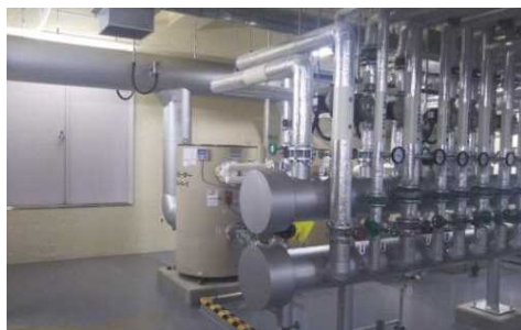
【余裕のある機械室 （岩内町役場）】
