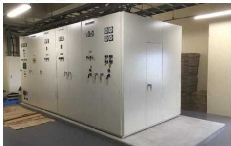
【機器の増設を考慮した電気室 （岩内町役場）】
