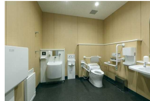
【多目的トイレ（愛西市 HP）】
