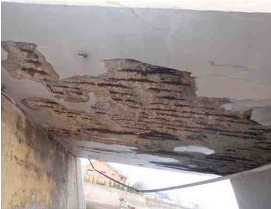
床版の鉄筋露出
