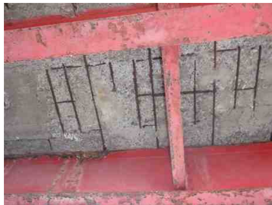
床版の鉄筋露出
