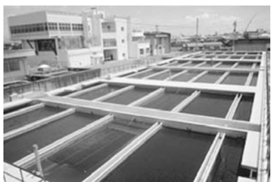
老朽化した浄水場
