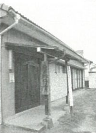
老朽化が進む集会所
